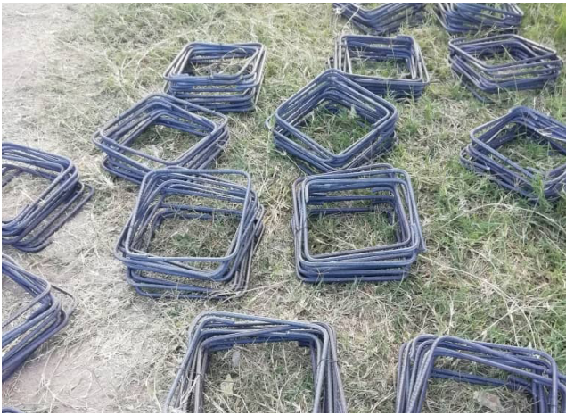
Abb. 5: Teile des gebogenen Bewehrungsstahls
